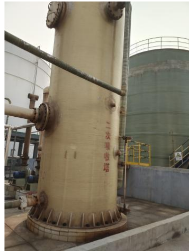
盐酸废气“水吸收”装置 (盐酸管道起点)
