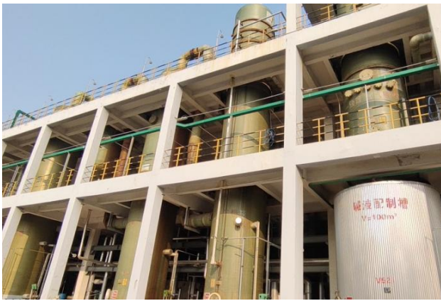
液氯废气“两级碱液吸收”装置
