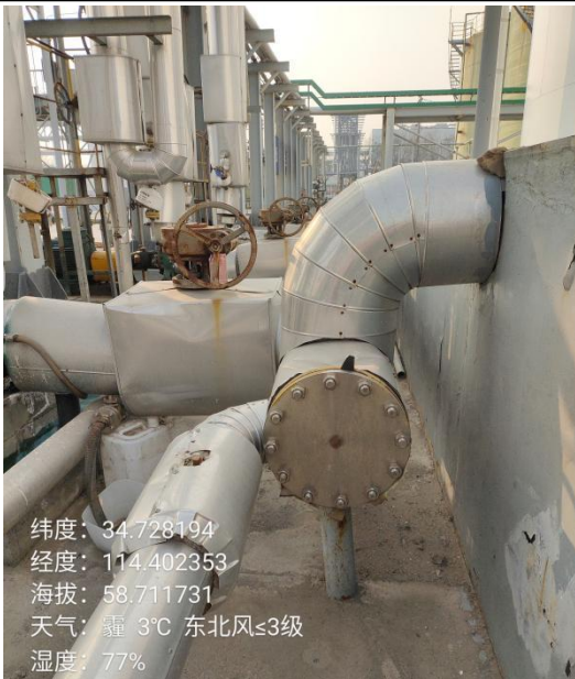
烧碱管道起点
