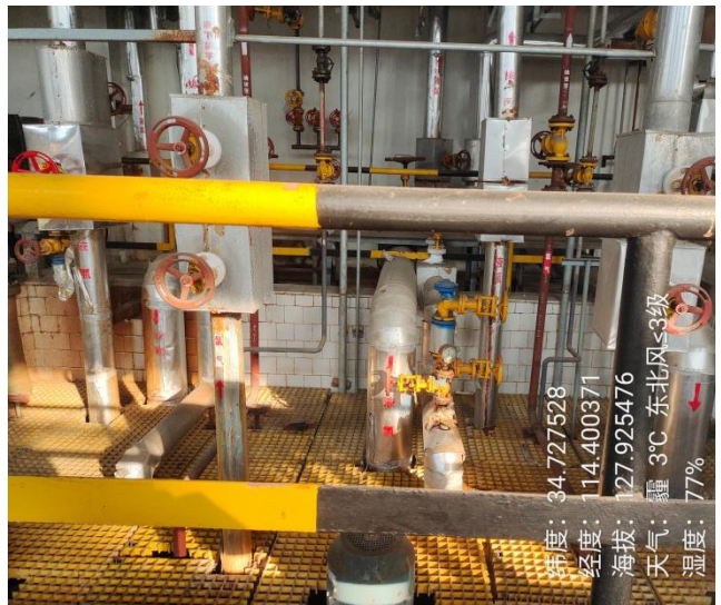
液氯管道 1、2、3 起点
