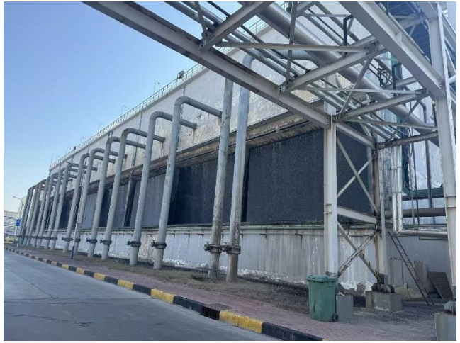
南厂区循环水站
