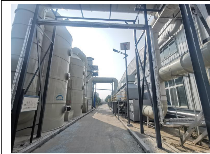
废气处理设施现状
