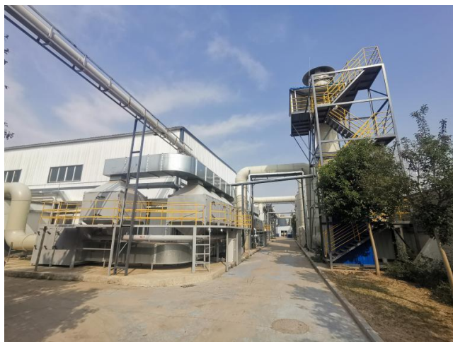
废气处理设施现状
