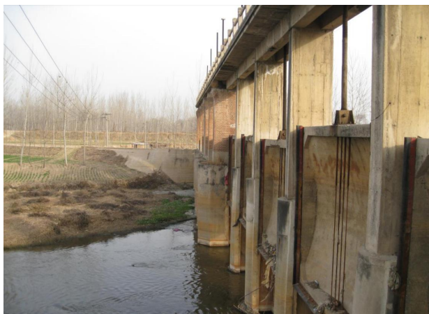
罗寨闸闸门铁件锈蚀
