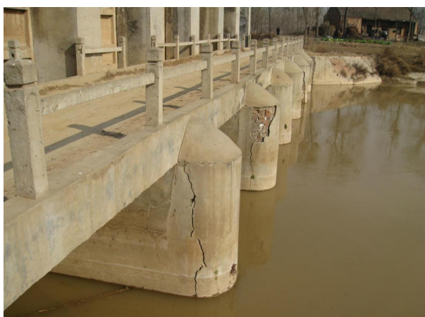
王庄闸下游闸墩裂缝
